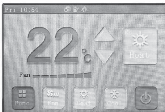
Gerät außer Betrieb
